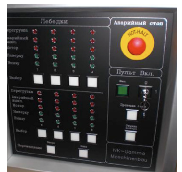
Steuertableau verfügt über die notwendigen Störmeldungen und Not aus Taster, sowie einen Schlüsselschalter.
